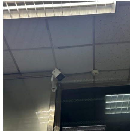
无损检测机房监视装置
