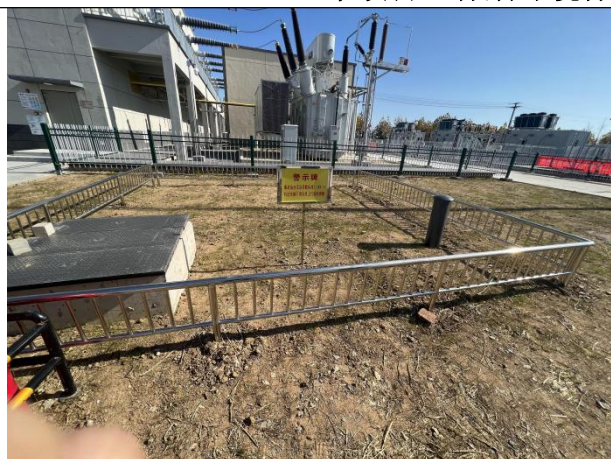
图 6.1-6 陆上集控中心事故油池
